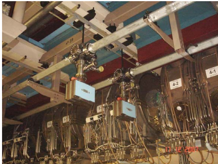
Рис. 31. Алюминиевые вакуумные камеры прямолинейных промежутков ускорителя-рекуператора 2 й очереди с блоками откачки и диагностики.
